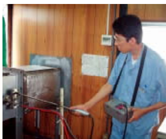
排気ダクトの測定に
